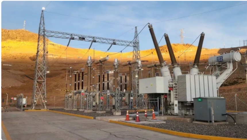
Subestación eléctrica ISA Foto: ISA
