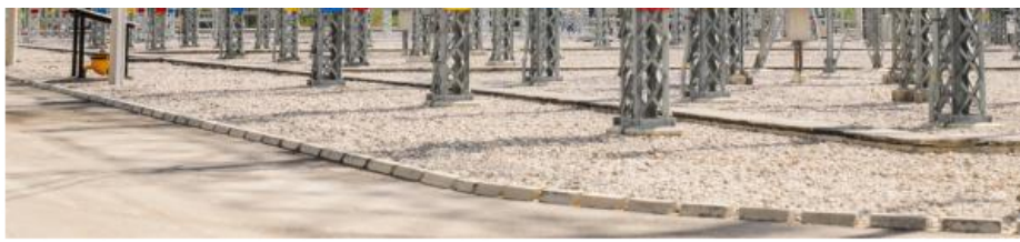
Línea de transmisión Colectora FOTO:UPME
