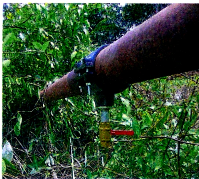
Más de 450 válvulas se registraron en el Transandino. Ecopetrol
