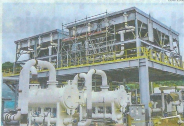
Infraestructura de la estación compresora Filadelfia de Promigas en Sucre.
