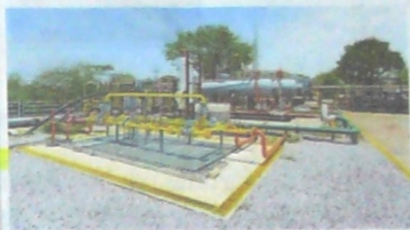
Planta de Gases del Caribe en El Difícil, Magdalena.
