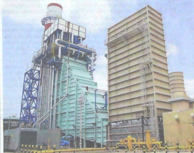
Instalaciones de la Zona Franca Celsia (antes Termoflores) en Barranquilla.
