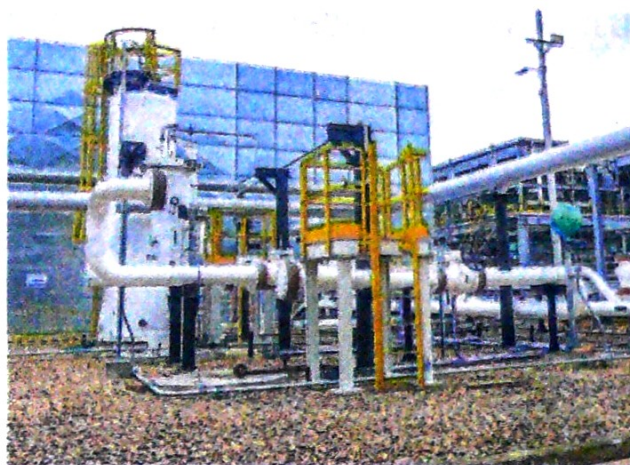
Estación Compresora Filadelfia. Promigas
