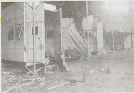
ASI QUEDARON LOS EQUIPOS que fueron dinamitados en la planta de inyección en Campo Tibú.
